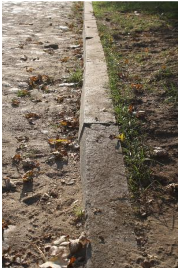
Fot.12 Widok krawężnika – uszkodzenia krawężnika kamiennego.
