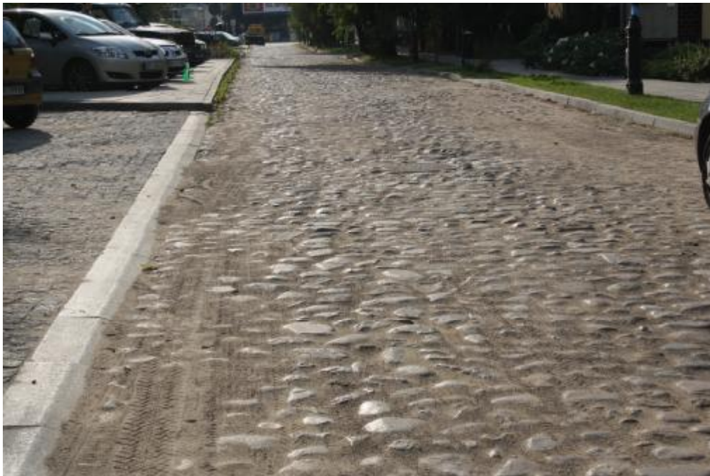
Fot.13 Widok krawężników – widoczne załamania linii prostej ułożenia krawężników.
