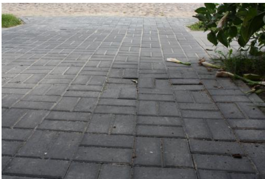
Fot.14 Widok zapadniętej nawierzchni wjazdu przy posesji Okrężna 13.
