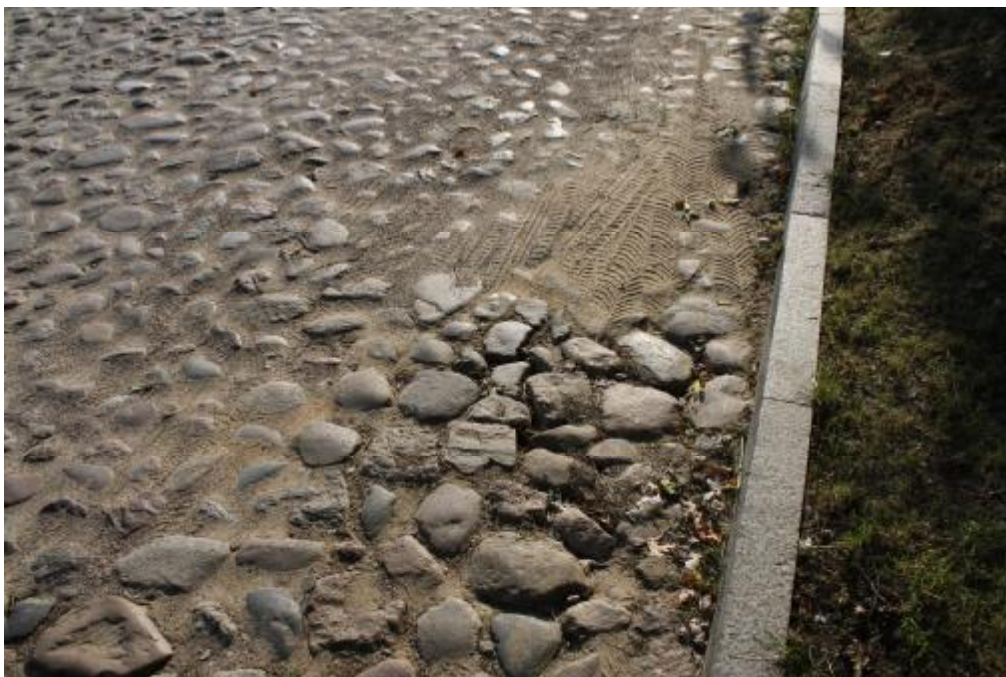
Fot.6 Widok ułożenia poszczególnych kamieni – widoczna przypadkowość doboru kamieni.
