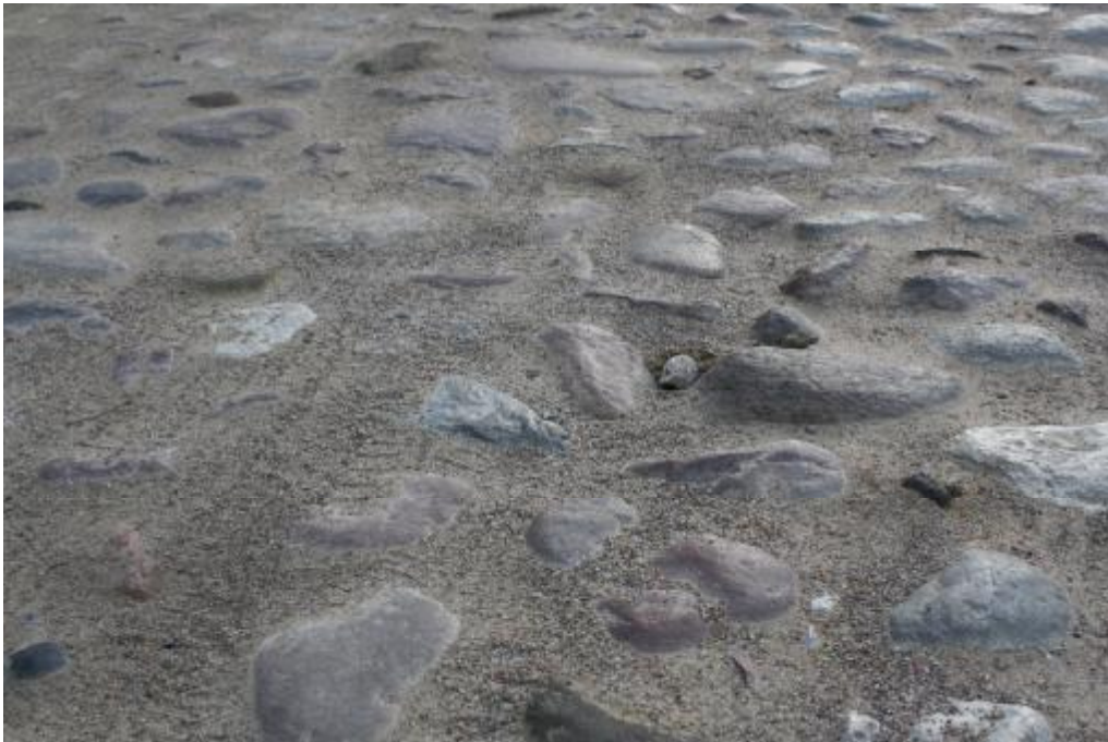
Fot.5 Widok ułożenia poszczególnych kamieni – widoczne pojedyncze wypadanie kamieni.
