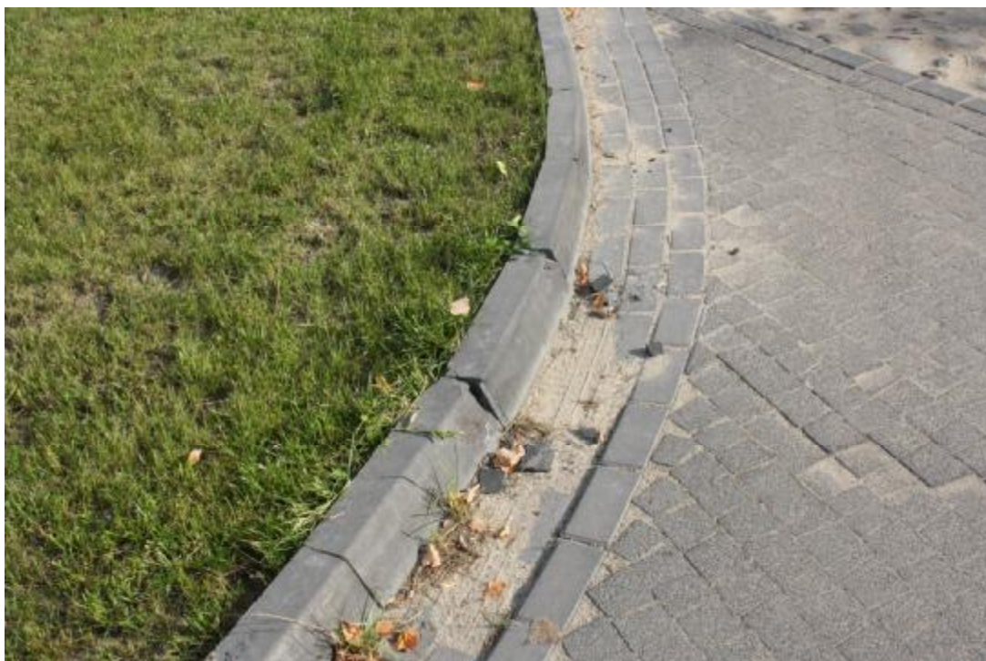
Fot.11 Widok krawężnika – uszkodzenia krawężnika betonowego.
