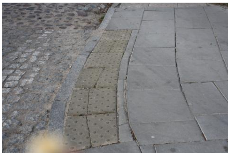
Fot.15 Widok popękanych płyt ryflowanych na przejściu dla pieszych przy skrzyżowaniu z ul. Cieplicką.
