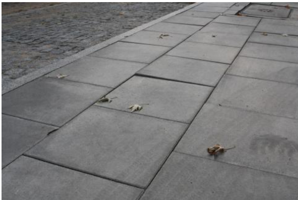
Fot.16 Widok luźno osadzonych płyt chodnikowych – chodnik po stronie północnej.
