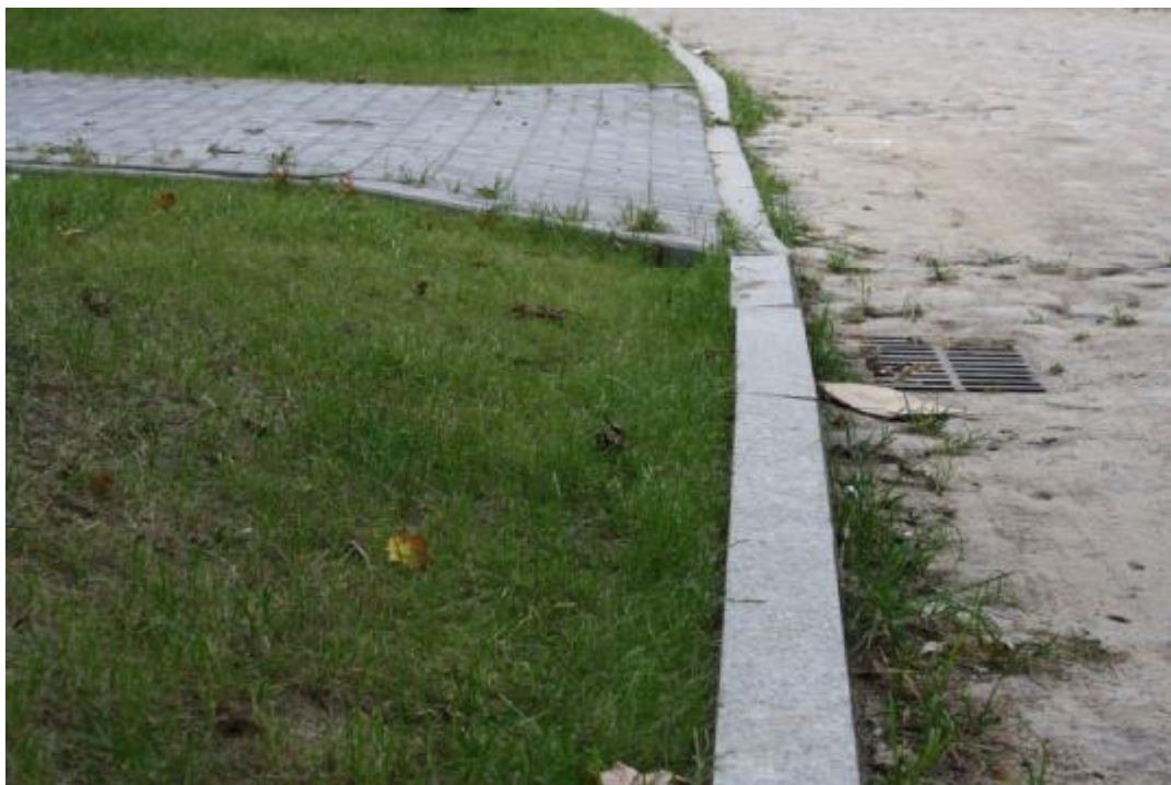
Fot.10 Widok krawężnika – przechylenie się krawężnika.
