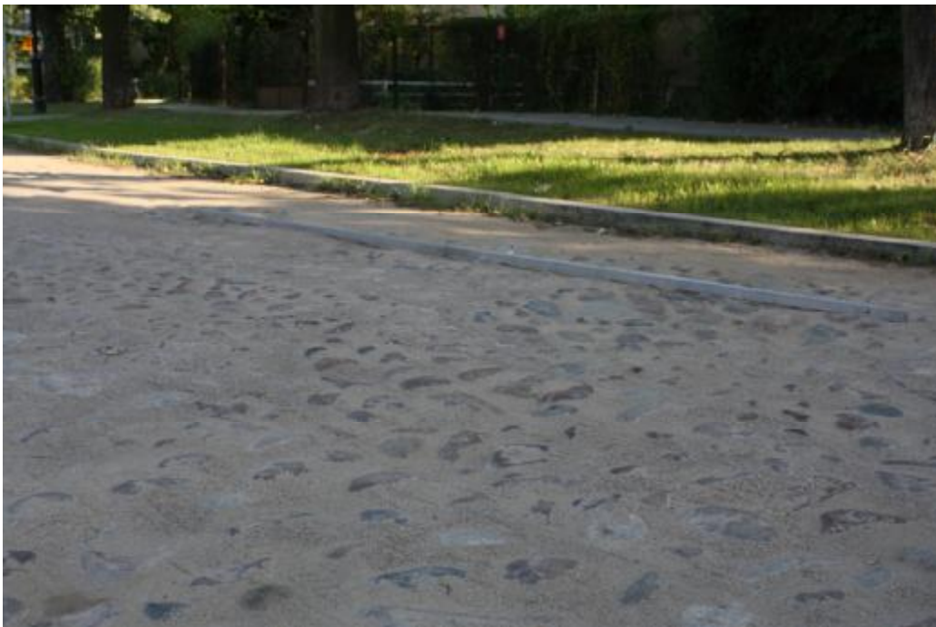
Fot.21 Pomiar nawierzchni – jezdnia południowa od strony chodnika - rejon Placu Rembowskiego.
